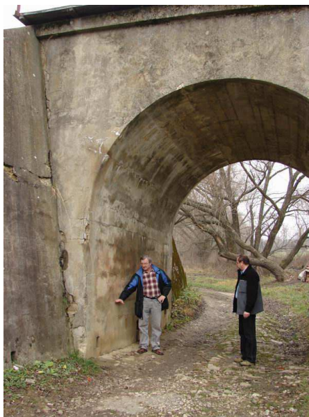
Obr. 3. Bahenné povodne z lokality Lazový jarok sa dostávali do intravilánu Starej Turej cez tunel v násype železnice. Ruka jedného z autorov tohto článku naznačuje výšku hladiny pri najväčšej zo štyroch povodní, ktoré sa tu vyskytli (dokumentované 28.11.2006).
