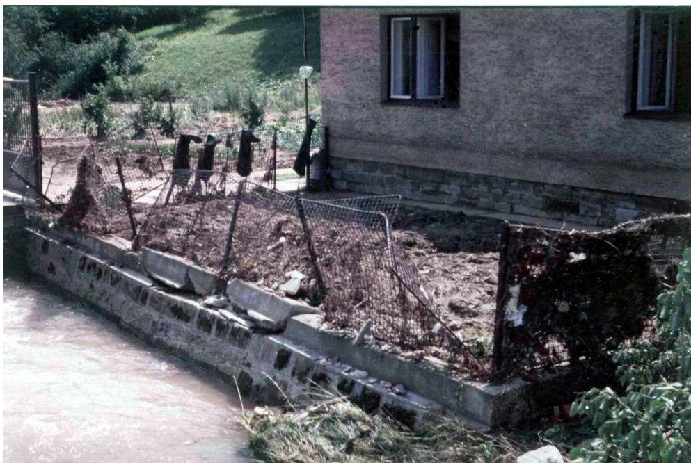
Obr. 4. Efekt povodne na toku Trstie v Topoleckej doline z 8.7.1997 (dokumentované 10.7.1997). Línia pod oknami na postihnutom dome naznačuje výšku povodňovej hladiny.
